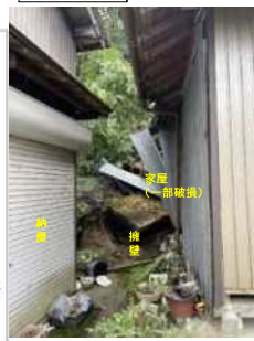
擁壁が移動して家屋が破損
