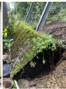
擁壁が家屋側へ傾斜
