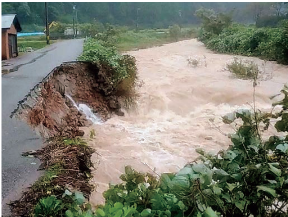
笹川の護岸欠損
