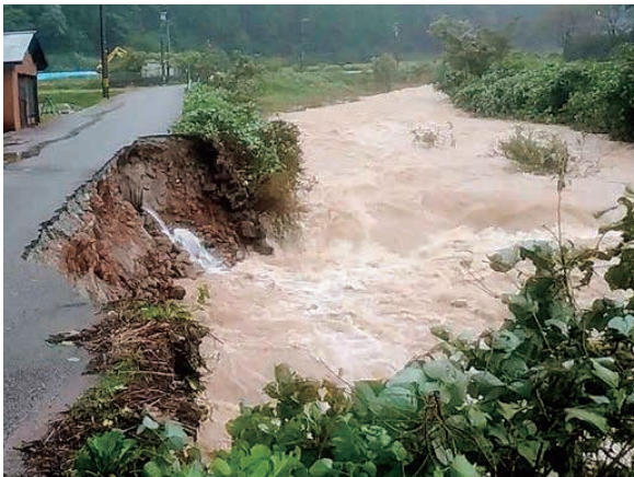
笹川の護岸欠損
