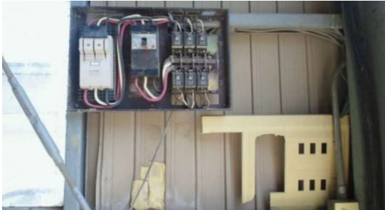
図1 配電器具の管理
