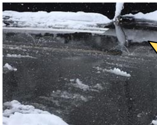
地下水を利用した消雪設備
