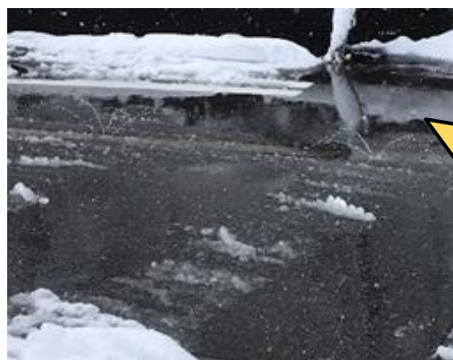
地下水を利用した消雪設備
