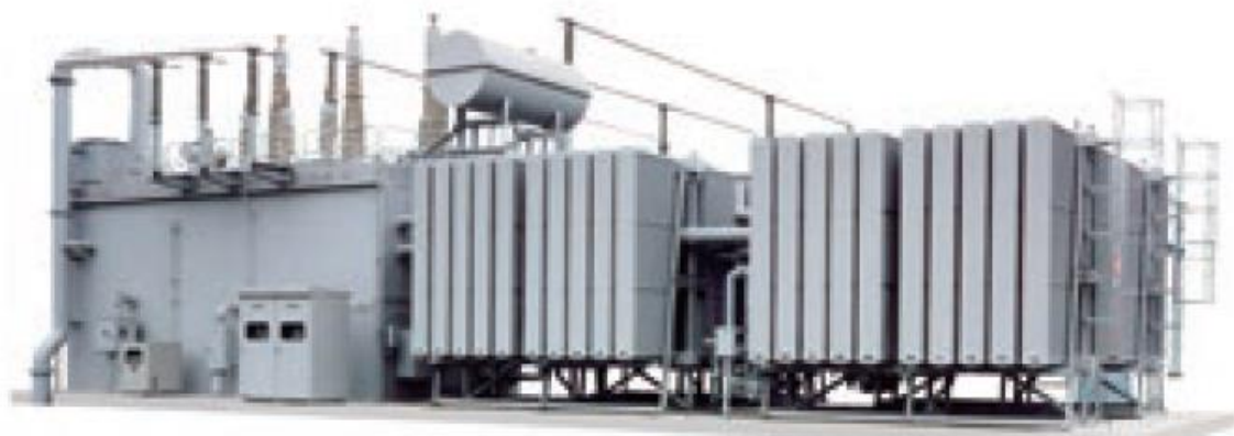
変電所に設置されたパネルラジエーター
