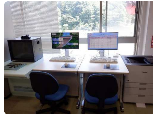
ダム管理用制御処理設備
