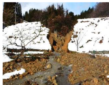
破堤したため池(氷見市)
