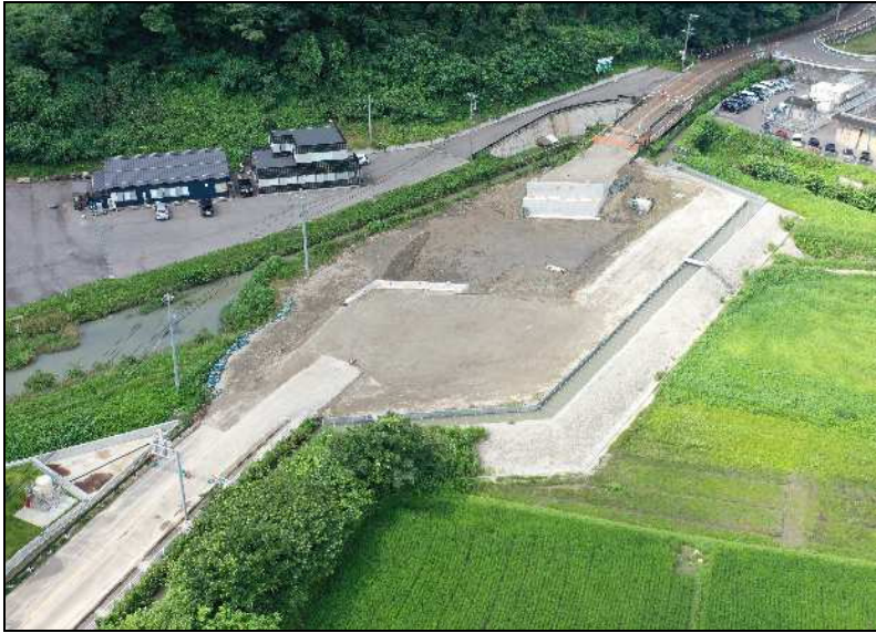
株式会社篠川組 都市基盤河川馬渡川改修に伴う 橋梁下部工工事 発注者 富山市
