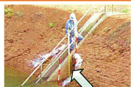
コンクリートと堤体境界部が浸食
