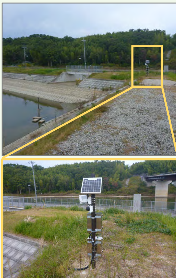
▲ ICT機器（水位計、カメラ）の設置状況
