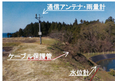
ICT水位計の設置状況
