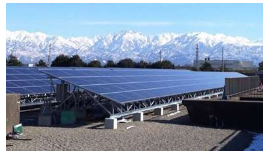
神通川浄水場太陽光発電所（富山市）
