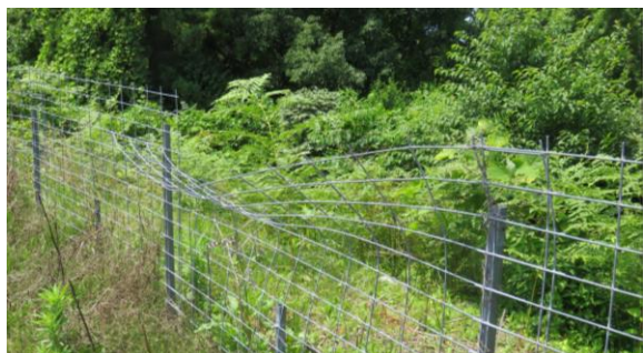
跳び越えによる柵上部の破損
