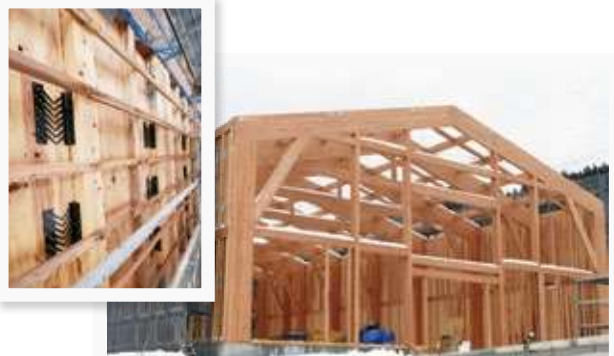
▲CLT(直交集成板)で建築したウイスキー熟成庫(南砺市) (写真左上)木材研究所で開発したダンパー付きCLT耐力壁
