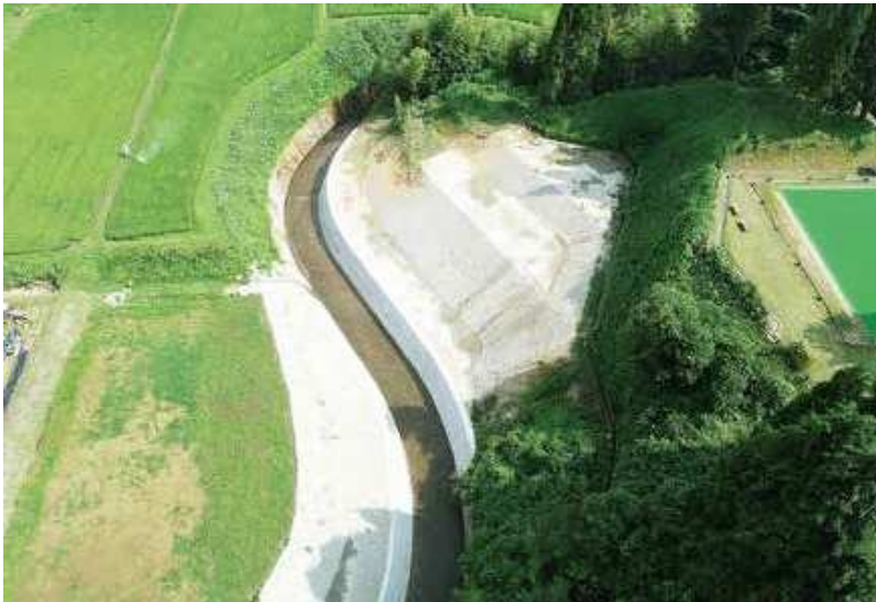
山田建設(株)施工の「庄川水系和田川砂防災害復旧護岸工工事」
