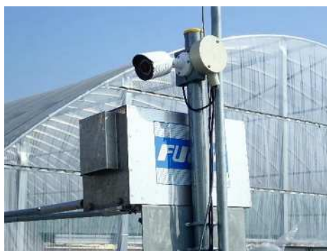
防犯カメラの設置
