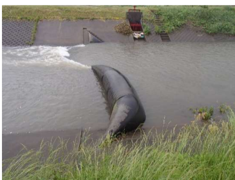
ゴム堰袋体(左岸側が完全倒伏不可)
