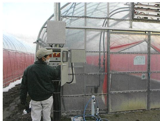
ハウスと制御盤
