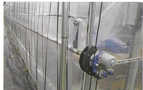
写真2 ハウスの側窓開閉の自動化
