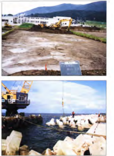
遺跡を保護するための盛土作業 (上) 波消しブロックを再利用した護岸工事 (下)
