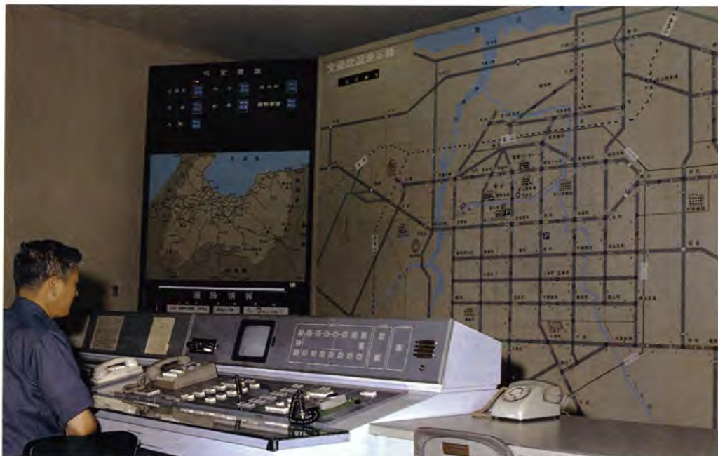
▲ 交通の流れを管理する管制室
