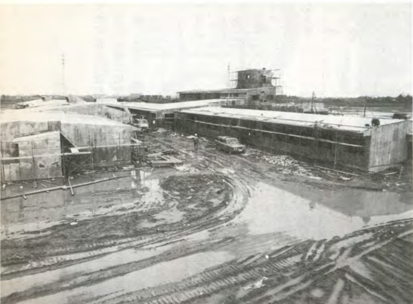
富山市針原地内の広大な敷地に建設が急がれる〈社会福祉総合センター〉写真は移転建築中の高志学園
