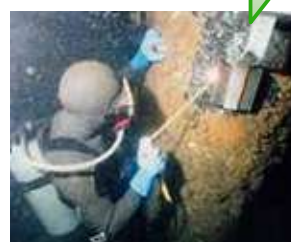
港湾岸壁の防食機能維持
