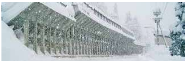
雪崩対策施設
