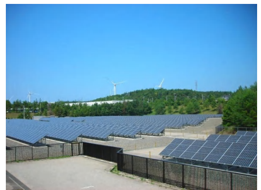
志賀太陽光発電所のソーラーパネル 約五千枚のパネルを合計すると「メガソーラー」と呼ばれる、出力1000kW(=1MW)の規模になり、年間300トンの二酸化炭素を削減することができます。
