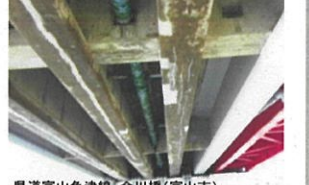
県道富山魚津線(今川橋(富山市)) 現橋の損傷状況
