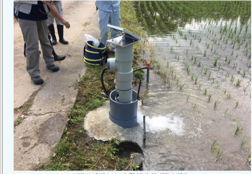
ICTを活用した自動給水栓(管水路)
