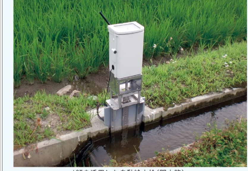
ICTを活用した自動給水栓(開水路)
