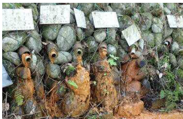
横ボーリング孔の閉塞状況
