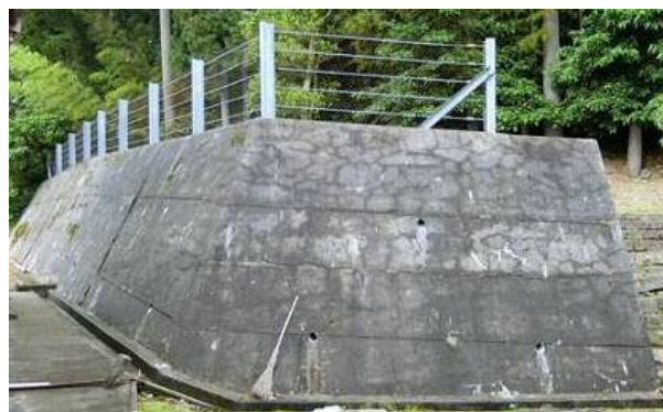
アルカリ骨材反応による亀甲状のひび割れ
