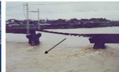
図5-8 洪水時の洗掘による鉄道橋梁の落橋（昭和51年9月洪水 Q_p = 約 2,650m 3 /s）
