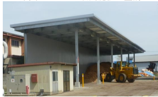
木質バイオマス利用施設の整備
