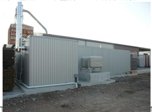
再生基金により整備した木材乾燥施設
