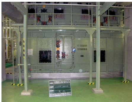
生物脱臭設備
