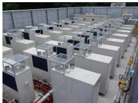
消化ガス発電施設
