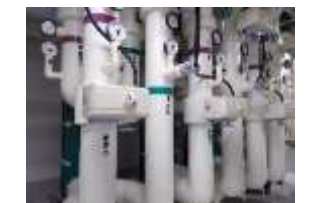
地中熱利用空調設備（県美術館）
