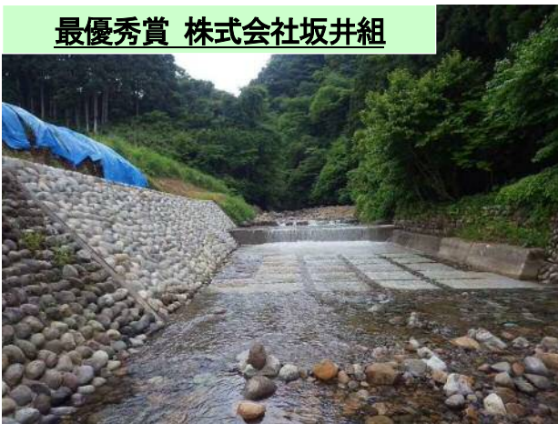
白岩川水系白岩川河川災害復旧(目桑工区)床止工事…③
