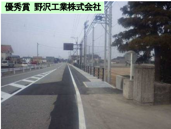
主要地方道立山水橋線道路総合交付金(交安)道路改良工事…⑤
