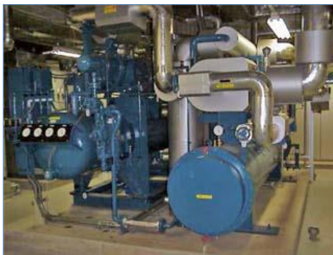
海竜スポーツランド ヒートポンプ（射水市）
