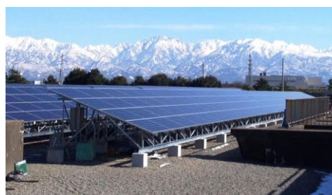
神通川浄水場太陽光発電所
