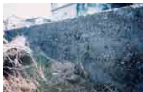
（護岸の老朽化状況・側面部）
