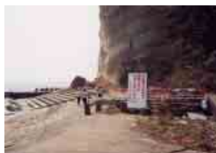
(城ヶ崎岬の崩落の状況)
